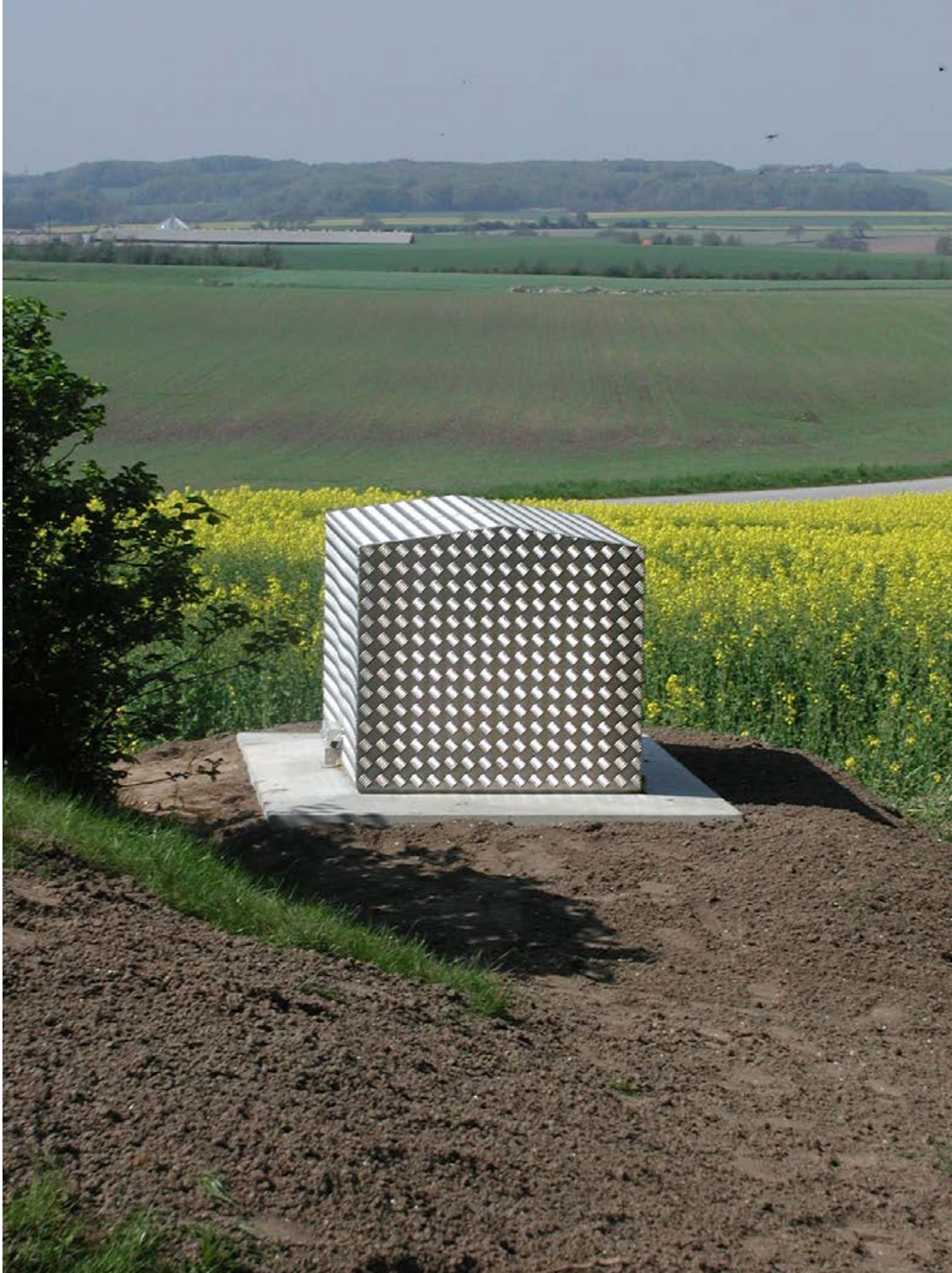
Råvandsstation ved en vandboring
